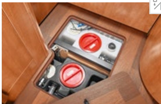
Vanntanker er frostsikkert plassert i det oppvarmede dobbeltgulvet
