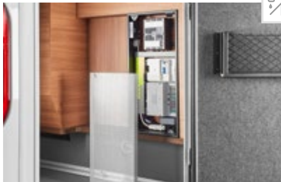
El-sentralen er lett tilgjengelig i hekkgarasjen
