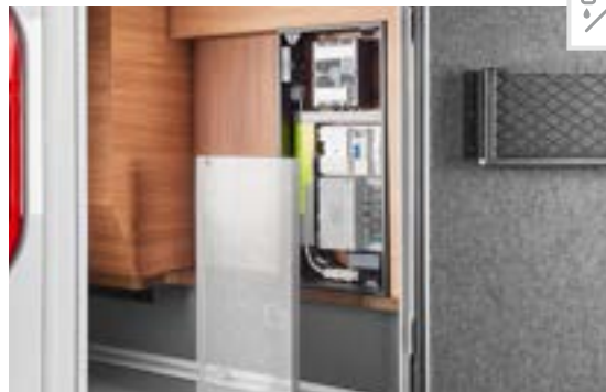
El-sentralen er lett tilgjengelig i hekkgarasjen
