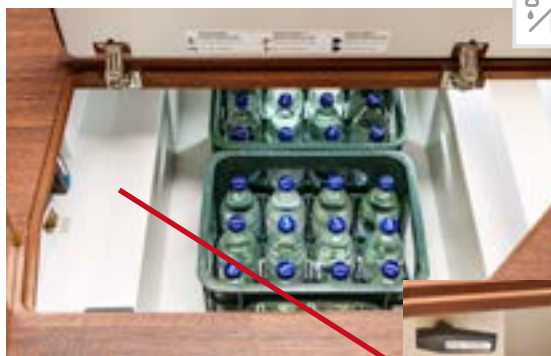
Vannavløpssentral og vanntanker frostsikret under dobbeltgulvet – kan også betjenes utenfra gjennom bodelsdøren
